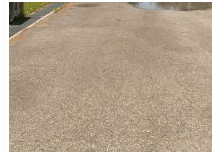
<부대시설 배수지 장내 포장부 균열>
