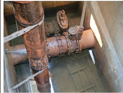
<통합밸브실 유출 밸브, 배관, 볼트류 부식>
