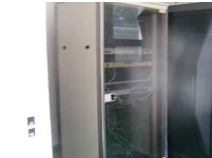
<전기실 전기설비 상태양호>
