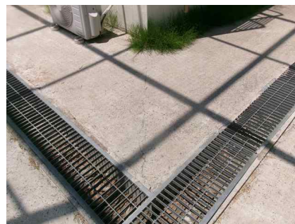
<검수실 외부 바닥기초 균열>
