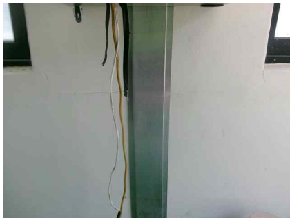
<전기실 내부 벽체 균열>
