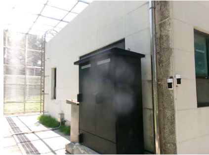
<검수실 외부 전기설비 상태양호>
