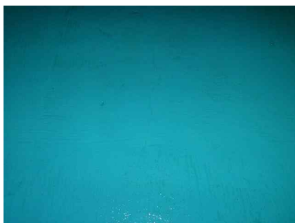
<배수지 1지 벽체 균열(0.3mm미만)>
