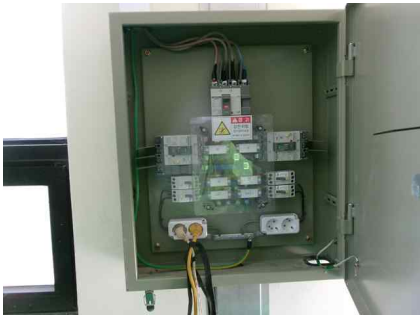
<전기실 전력 배전반 상태양호>
