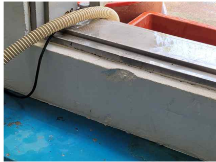
<펌수실 내부 배면 벽체 파손>
