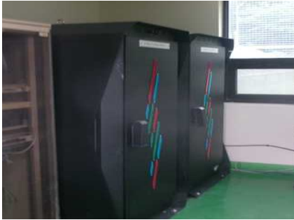
<전기실 전기설비 상태양호>
