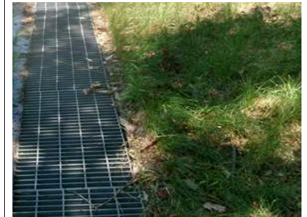
<부대시설 배수지 주변 사면 토사유실(상태양호)>
