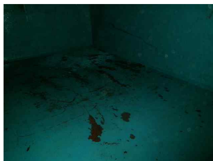
<배수지 1지 바닥슬래브 도장박리>
