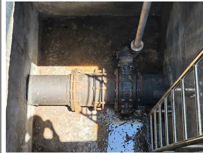
<1지 유입 밸브, 배관, 볼트류 현황>
