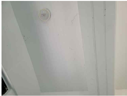
<펌수실 내부 상부슬래브 도장박리>
