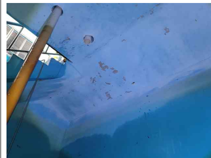
<배수지 2지 상부슬래브 도장박리>
