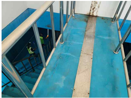
<펌수실 내부 바닥슬래브 균열>
