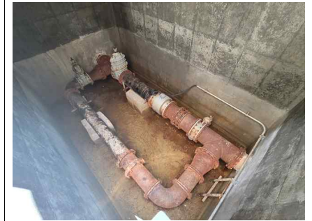
<유량계실 밸브, 배관, 볼트류 부식>
