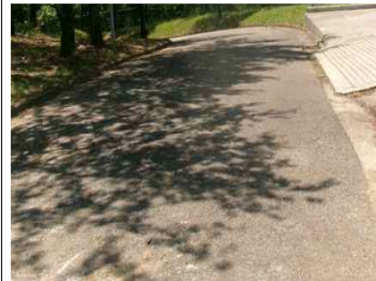
<부대시설 배수지 장내 포장부 균열>
