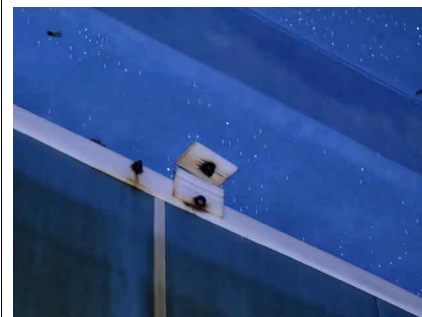
<배수지 2지 도류벽 브라켓 파손>
