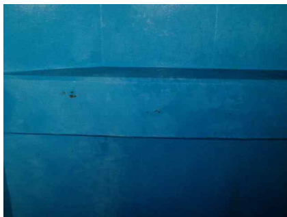
<배수지 1지 상부슬래브 녹물>
